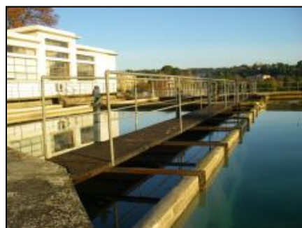
L'unité de traitement de Saint Eutrope
