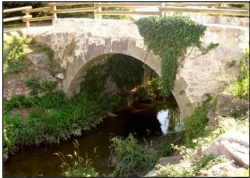
La Touloubre au niveau du pont de la Glacière à Puyricard, sur la commune d'Aix en Provence.
