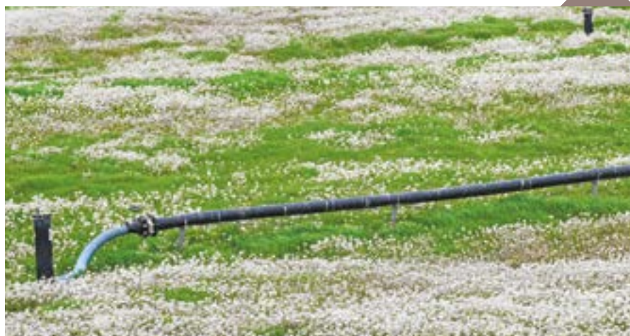
UN RÉSEAU DE Puits ET DE DRAINS PERMET DE CAPTER ET D'ACHEMINER LES BIOGAZ JUSQU'À L'UNITÉ DE VALORISATION ÉLECTRIQUE
