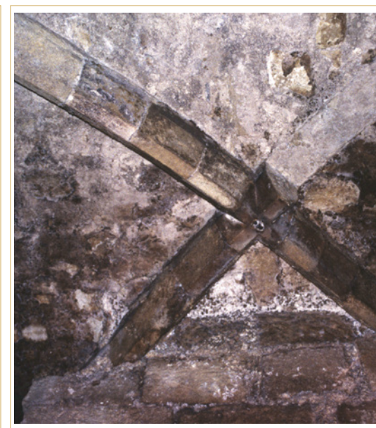
669 Détail du plafond voûté d'une cave toujours présente sous la place d'Albertas.
