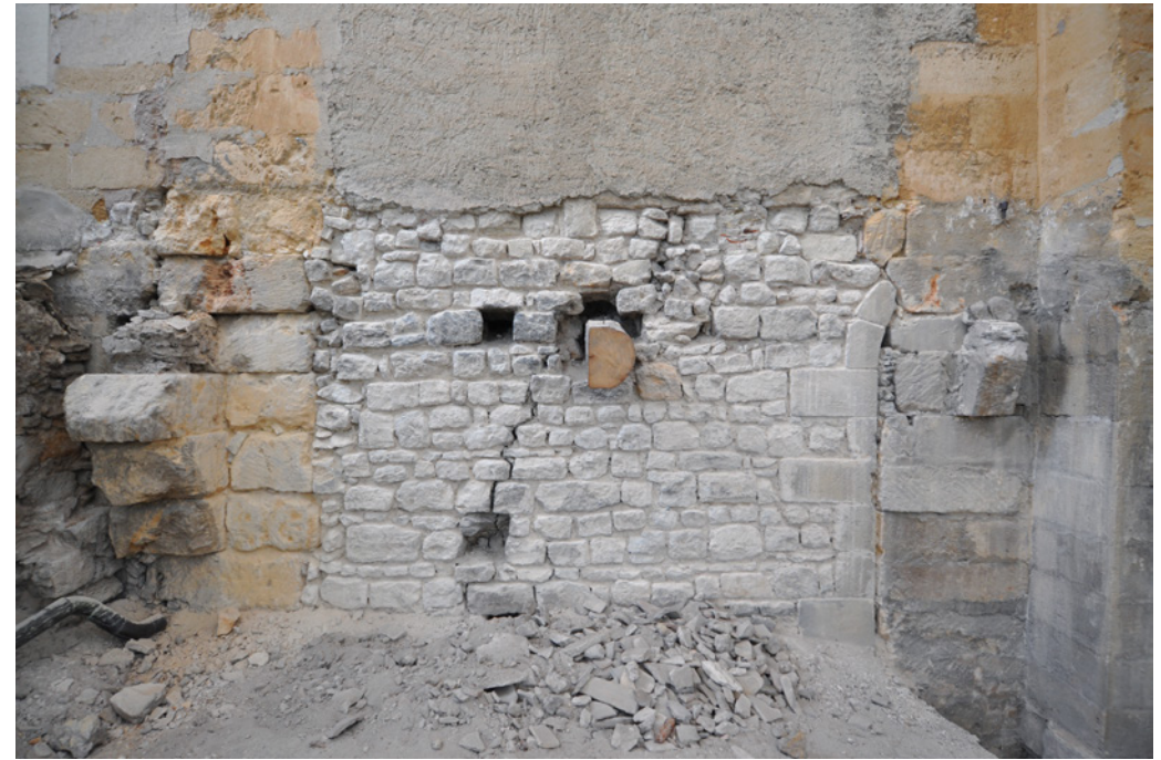
632 Vestiges du mur gouttereau sud médiéval de l'église des Prêcheurs et d'une fenêtre haute, retrouvés dans les combles de la première travée de la nef.
