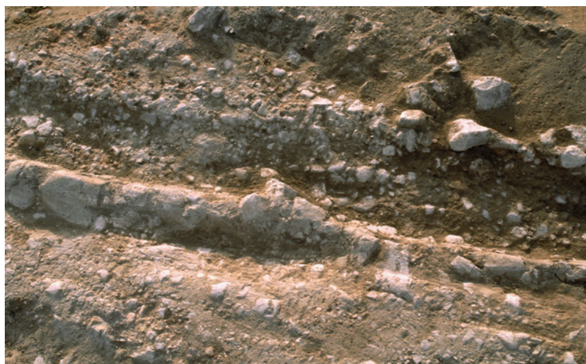
377 Détail des ornières
