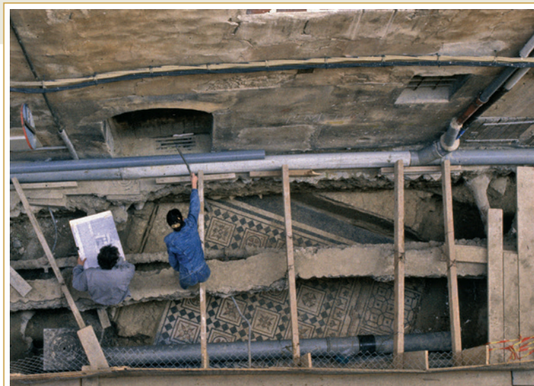
253 Intervention dans la rue des Magnans, en 1992. Vue du tapis de rallonge de la mosaïque représentant le combat de Darès et Entelle en cours de fouille.
